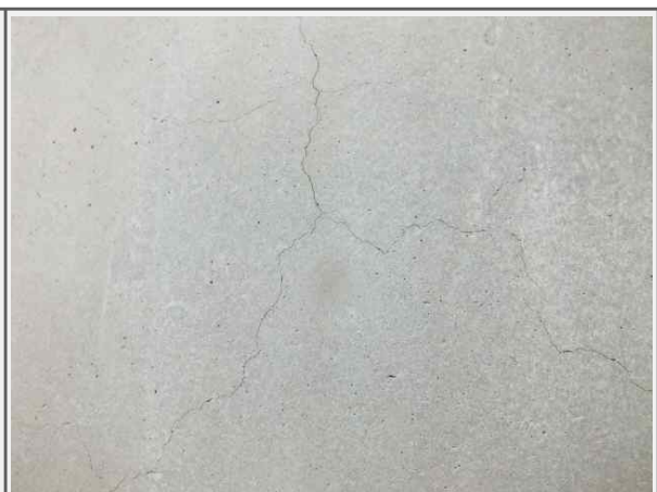
내 용 영천 P2 망상균열
