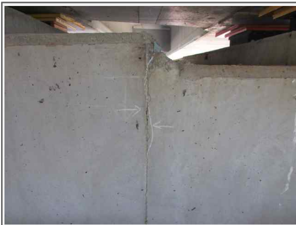
내 용 상주 P1 균열(cw=0.3mm)
