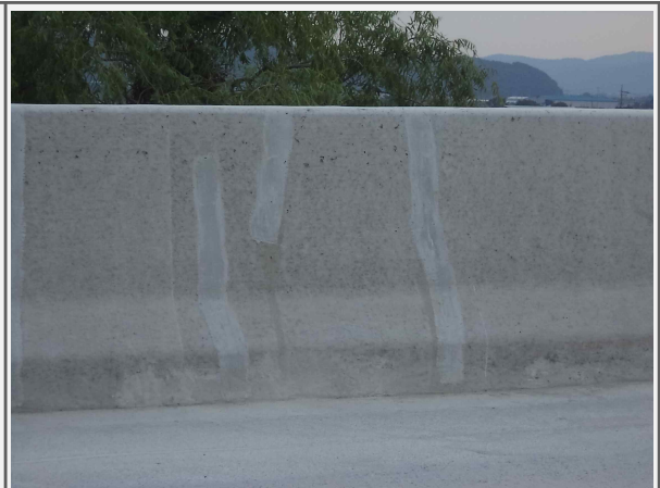
내 용 방호시설 균열보수
