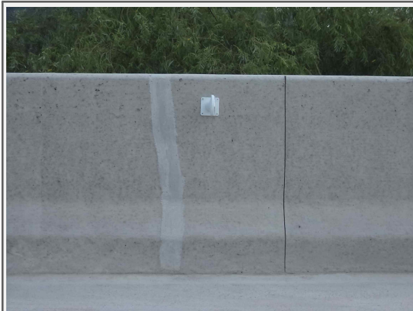
내 용 방호시설 균열보수
