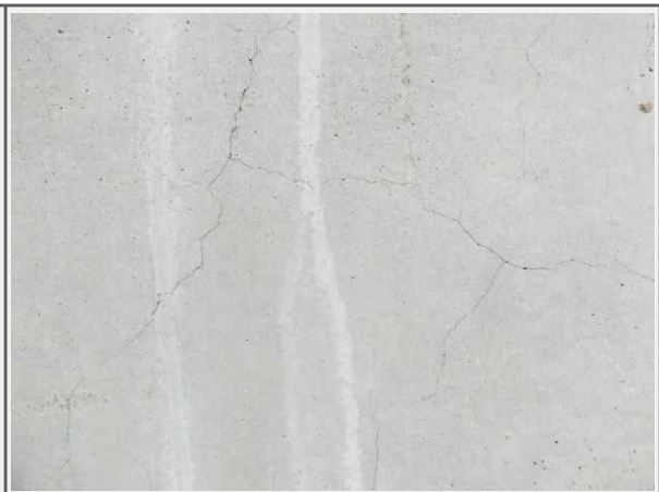
내 용 상주 P3 망상균열
