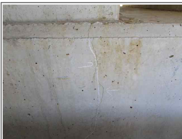
내 용 영천 P3 균열(cw=0.3mm)
